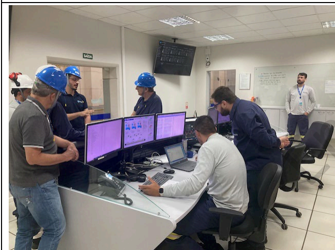
Foto 34: Sala de controle da casa de força
