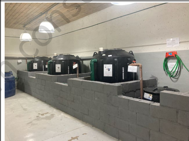
Foto 53: Tratamento de esgoto no andar mais baixo da casa de força
