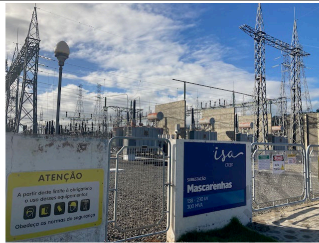
Foto 26: Subestação ISA CTEEP na UHE Mascarenhas
