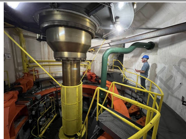
Foto 46: Poço do eixo do gerador
