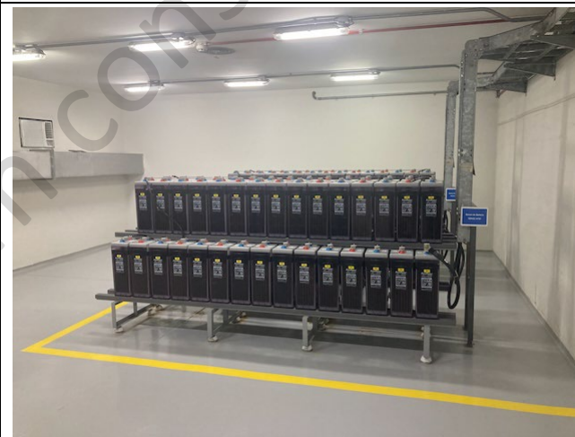
Foto 47: Sala de baterias
